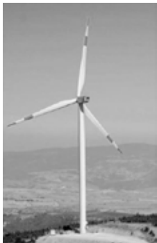
Figura 3-1. Señalización e iluminación de turbinas eólicas
