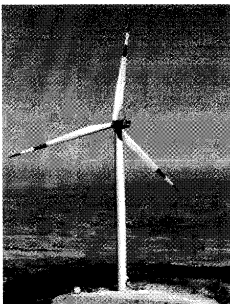
Figura 3-1. Señalización e iluminación de turbinas eólicas.
